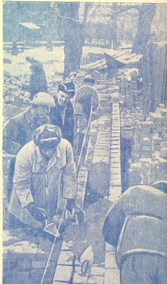
21 октября на строительстве тира был положен первый кирпич. Сейчас кладка идет полным ходом.
